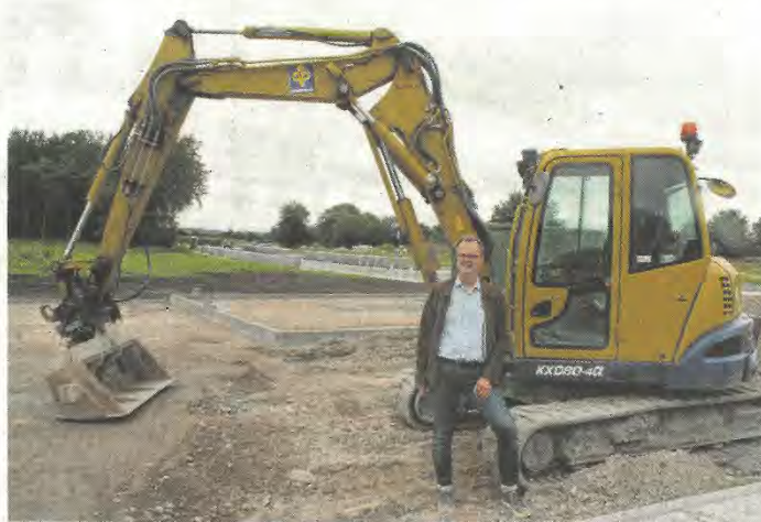
Frank Thomsen, technischer Geschäftsführer der Scanham-EGB, auf der XXL-Baustelle zur Erschließung des Gewerbegebiets Scanham. Bis Ende September sollen die Straßen asphaltiert sein.
